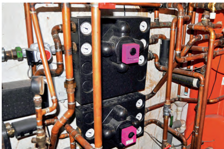
▲ Bild 6 • Beheizt wird das Haus von einem (älteren) Pflanzenöl-BHKW, das ehemals in einen Nahwärmeverbund einspeisen sollte, der aber nicht realisiert wurde. An dem drucklosen Kombipufferspeicher (1.000 l) hängt auch noch ein Holzofen mit Wassertasche, der ebenfalls sämtliche Zimmer beheizen könnte. Der Überdruck im Speicher darf nicht mehr als 0,1 bar betragen. Deshalb ist er über einen Wärmetauscher (ganz links) von der Heizungsanlage hydraulisch entkoppelt. Der untere „Rendemix“ ist für die Zweizonenbeladung des Kombipufferspeichers mit integrierten Wärmetauschern zuständig. Die Schichtung garantiert ausreichend Warmwasser für Küche und Bad. Der obere Mehrwegemischer diente der effizienten Einbindung der thermischen Solaranlage in Zusammenarbeit mit dem damaligen Spitzenlastkessel.
