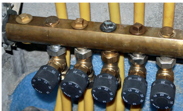
◀ Bild 3 • Rücklauftemperatureinstellung an den TRVs zwischen ca. 17 und 22 °C, je nach Raum und Wärmetauschergröße, Nutzung und Temperaturwunsch. Die Feinjustierung ist Sache des Nutzers.
