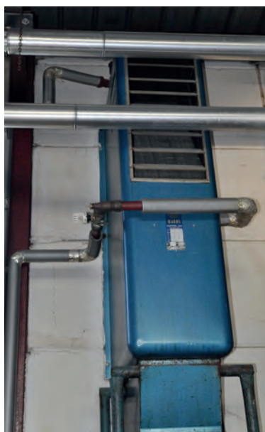
▲ Bild 7 • Rücklauftemperaturbegrenzer-Test in einer Chemiefabrik im belgischen Limburg mit einem RTB hinter jedem der 30 Warmwasser versorgten Lüfter. Das Thermo-Element verhindert, dass die Rücklauf-temperatur wegen geringer Wärmeabnahme des Wärmetauschers auf über 45 °C klettert, indem der erhöhte Differenzdruck die Förderleistung der Umwälzpumpe anpasst. Das Rücklaufwasser wird so brennwerttauglich.
