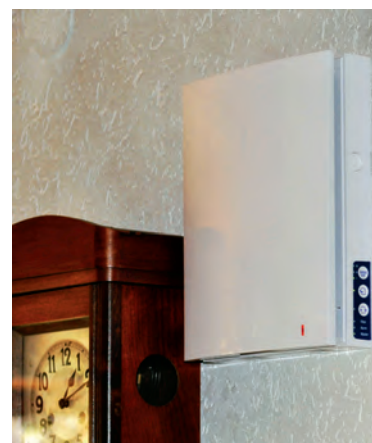
▲ Bild 8 • In den Zimmern sind dezentrale Einzelraumlüftungsanlagen mit keramischem Wärmerückgewinnern installiert. Sie wirken abwechselnd als Zu- und Abluftgeräte, in dem sie im 70-Sekunden-Takt von Abluft- auf Zuluftbetrieb umschalten. Jeweils zwei sind gegenläufig synchronisiert, um im Raumverbund Über- oder Unterdruck zu vermeiden. Für den Typ Vento-Expert gibt Hersteller Blauberg eine Förderleistung bis 50 m 3 /h und einen Wärmerückgewinnungsgrad von 97 % an. www.blaubergventilatoren.de
