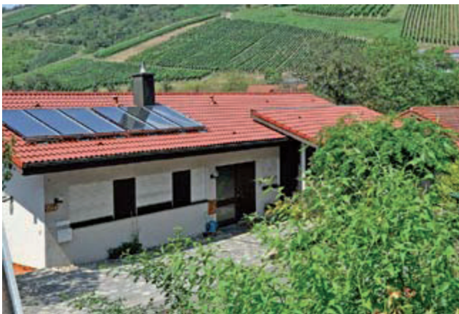
Hertweck-Installationen. Mit Rendemix halbiert sich die Amortisationszeit für den Kollektor
