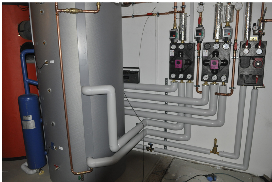
Objekt Baumgartner: Zwei Mehrwegemischer zur energieoptimierten Be- und Entladung der beiden 1000-l-Pufferspeicher. Links unten (blau) der Solarwärmetauscher am Puffer zur Warmwasserbereitung. Der rote Heizwasserpuffer war bereits vorhanden. Er ist an den silbergrauen Schichtenspeicher angebunden. Der Solarwärmetauscher fährt den Schichtenspeicher in vier verschiedenen Ebenen (Temperaturzonen) an
