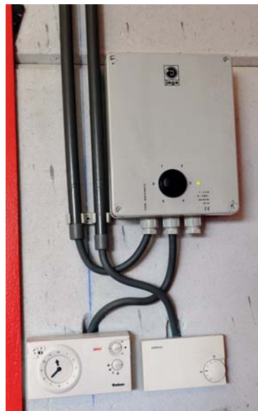
... sowie mit Frequenzumformern zur Drehzahlregelung der Ventilatoren
