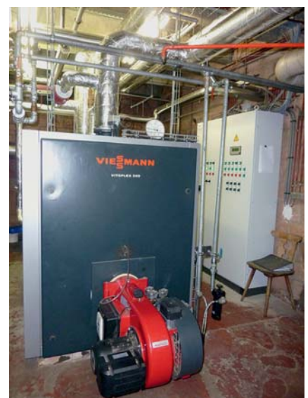
Bis zu 85 °C Vorlauftemperatur aus dem Ölbrennwertkessel (Viessmann Vitoplex) mit 700 kW Leistung
