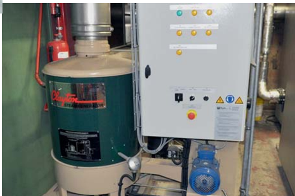
Erneuerter heizölbefuerter Dampferzeuger (Durchlaufprinzip) zur bedarfsgerechten Beheizung der Mischbehälter in der Produktion, Dampfproduktion bei 1 bar 157 kg/h
