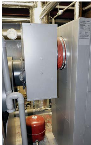
Der externe Latentwärmetauscher hinter dem Ölkessel (ganz rechts, Viessmann Vitotrans) gestattet den Anschluss eines separaten Heizungsrücklaufs und damit Brennwertnutzung bei hohen Vorlauftemperaturen (Erklärung siehe Text). Die silbergraue Abgasbox zwischen Tauscher und Kessel gleicht lediglich die unterschiedlichen Höhen von Kesselaustritt und Wärmetauscher-eingang aus
