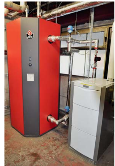
19-kW-Ölbrennwertkessel (Vaillant icovIT) zur ganzjährigen Warmwasserbereitung
