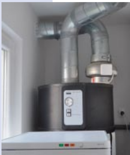
Die Luftwasserwärmepumpe zur Brauchwassererwärmung (Typ WPL 5030 EW) bezieht ihre Energie aus den Abluftströmen der kontrollierten Wohnungsbe- und -entlüftung
