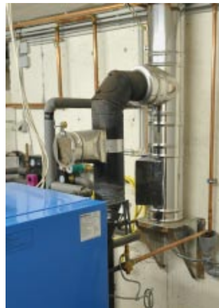
Der Festbrennstoffkessel „Logano S 151“ steht im ehemaligen Luftschutzkeller. Da kein Kamin vorhanden war, mussten die Anlagenbauer einen Edelstahlschornstein einziehen. Im Vordergrund die thermische Abfallsicherung für den Fall einer Kesselüberhitzung
