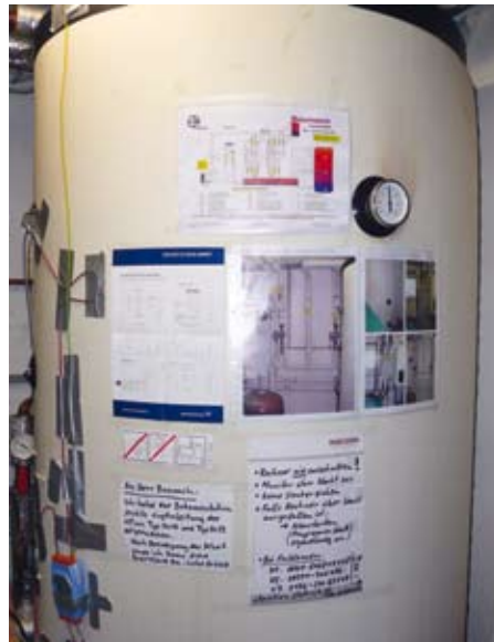
Bild 5 Für die Untersuchung der Speichereffizienz wurden am 1000-l-Pufferspeicher mehrere Temperatursensoren über die Speicherhöhe verteilt platziert
