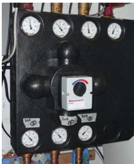
Bild 8 Für die Zwei-Zonen-Be- und Entladung des Pufferspeichers wurden die vorhandenen Dreiwege-Mischer durch Mehrwege-Mischverteiler vom Typ Rendemix 3x4 ersetzt
