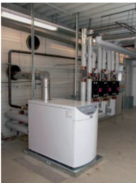
Ecocraft-Heizungsanlage im Technik-/Schulungs-Raum bei R + F in Kassel
