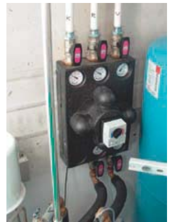
■ Der rendeMIX zwischen BHKW und Pufferspeicher bewirkt, dass der Speicher nach dem Zwei-Zonen-Prinzip beladen wird. Bild: H.-G. Baunach
