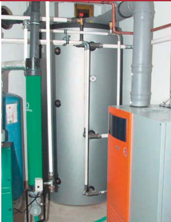
■ Die Wärmegrundlast wird durch ein Dachs-BHKW von Senertec gedeckt, das auf den Pufferspeicher (Bildmitte hinten) arbeitet. Die Nachheizung übernimmt ein 130-kW-Gasbrennwert-Mittelkessel von Wolf Heiztechnik.
