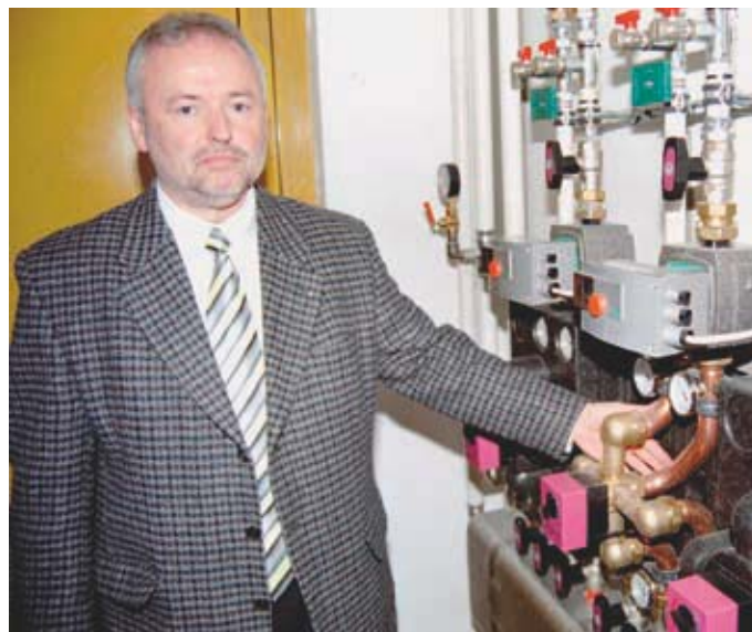
■ Wolfgang Mika, Verkaufsleiter von Richter + Frenzel in Schweinfurt, rechnet durch die Optimierung der Anlagenhydraulik mit erheblichen Einsparungen bei den Energiekosten.
