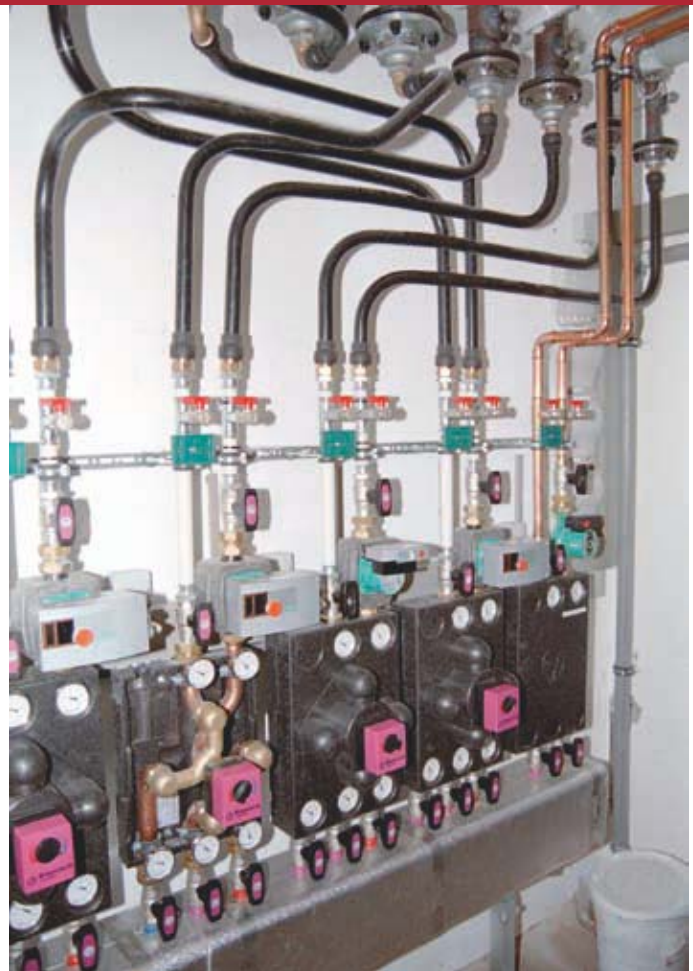
■ Für die Wärmeverteilung der Heizkreise wurden die Mehrwege-Mischventile von HG Baunach zusammen mit einem neuartigen Dreikammerverteiler von Magra eingesetzt. Die Reihenfolge der Verteilerabgänge richtet sich dabei nach dem Temperaturgefälle im Rücklauf in Fließrichtung zum Kessel. Bild: W. Heint
