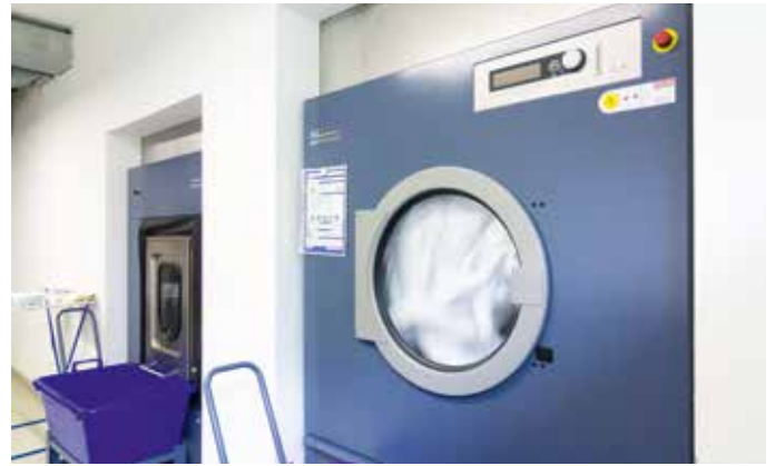
Die Rückseite der Waschmaschine ragt in den Nachbarraum. Hier wird die saubere Wäsche aus der Waschmaschine genommen und in den Trockner (hier rechts) gefüllt.
