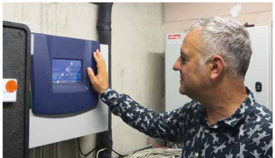
An der varmecoregulation lassen sich die Wärmequellen priorisieren. Dadurch erhält das BHKW Vorrang vor dem Brennkessel und läuft etwa 6000 Stunden pro Jahr.
