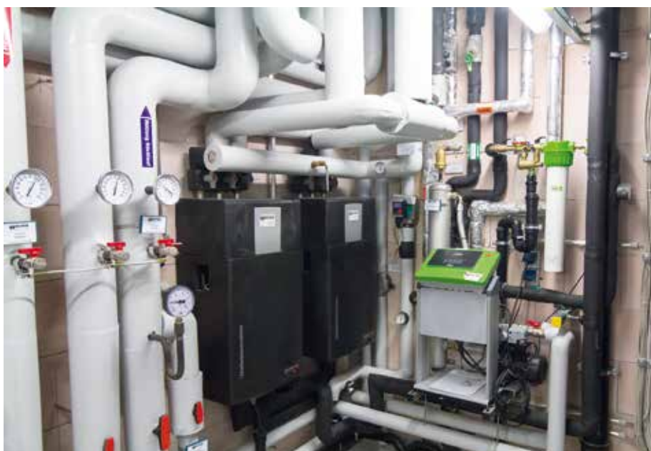
Eine energieoptimierte Kaskade von Frischwasserstationen trägt ihren Teil dazu bei, die Temperaturspreizung – und somit die thermische Effizienz – der Gesamtanlage zu maximieren.
