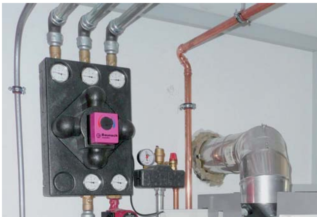
Rendemix-Gruppe zur Rücklaufanhebung des Holzheizkessels und optimalen Schichtung des Pufferspeichers
