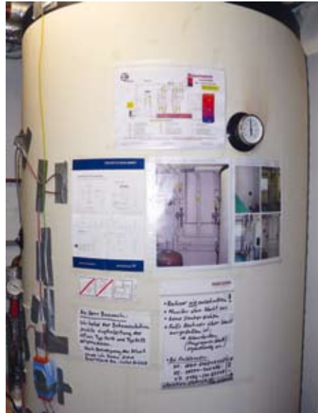
Bild 5 Für die Untersuchung der Speichereffizienz wurden am 1000-l-Pufferspeicher mehrere Temperatursensoren über die Speicherhöhe verteilt platziert
