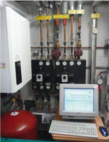
Bild 4 Der Heizraum als Versuchslabor: Während der laufenden Untersuchung des Anlagenbetriebs mit zwei verschiedenen Pufferladeverfahren wurden permanent die Messdaten erfasst und per Datenfernübertragung zur Auswertung in die Hochschule Biberach übermittelt
